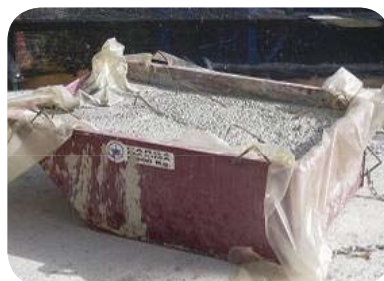
Hay que acopiar debidamente el hormigón sobrante de homrignado
